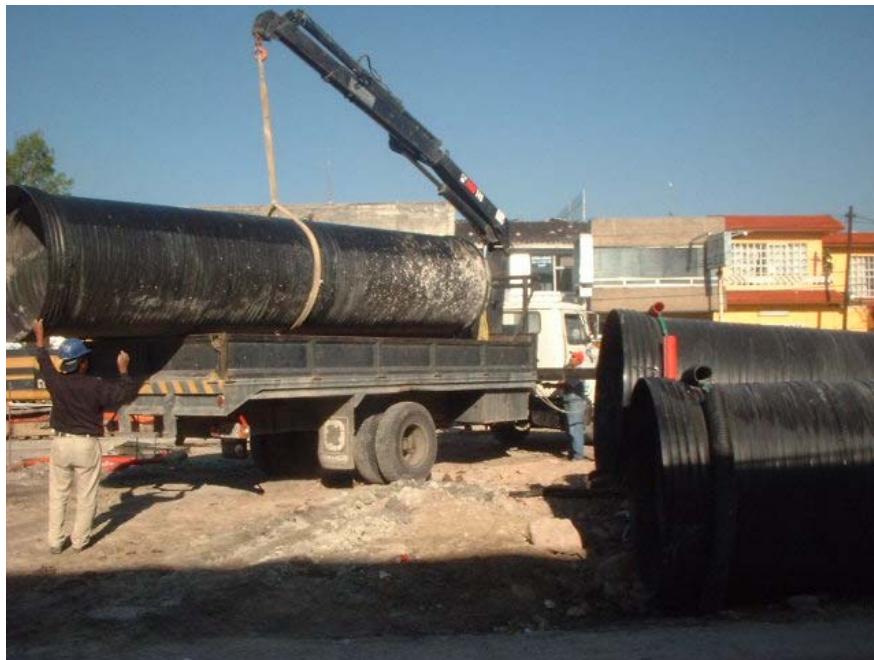
Figura No. 10 tubería de polietileno ADS 12
