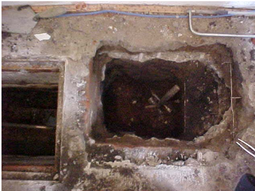
Figura No. 6 drenaje sanitario destrozado y azolvado en acceso a registro 5
