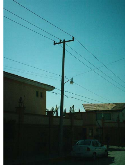
Foto 45.- Electricidad y alumbrado publico
