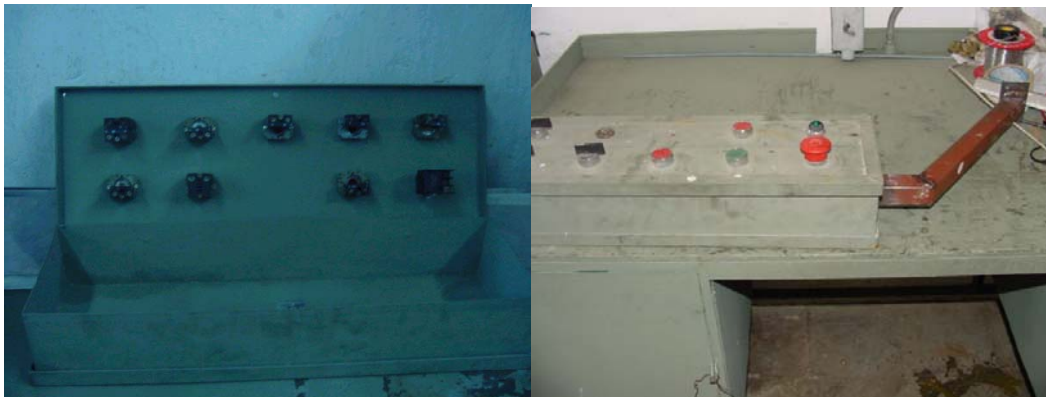
Figura 5.4 Tablero de control
