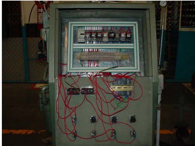
Figura 5.7 Conexión del sistema eléctrico
