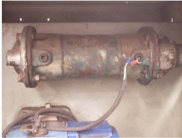
Figura 2.6 Intercambiador de calor
