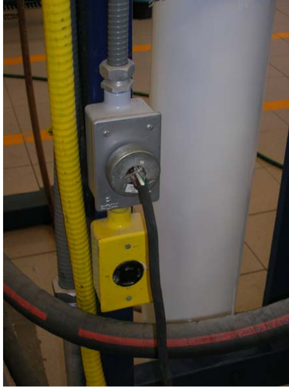
Figura H.5. Toma de corriente para el motor de la bomba de vacío.
