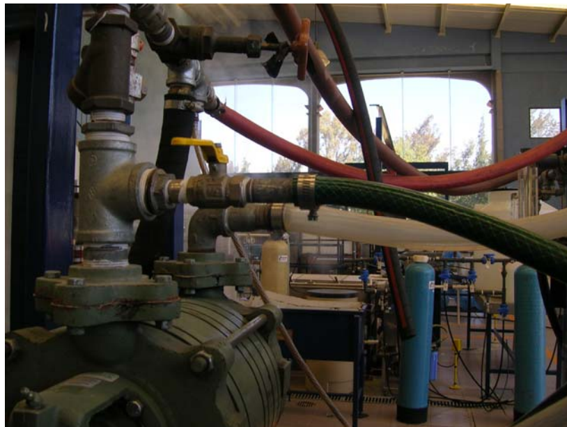
Figura H.6. Mangueras que hay que desconectar y destapar regularmente.
