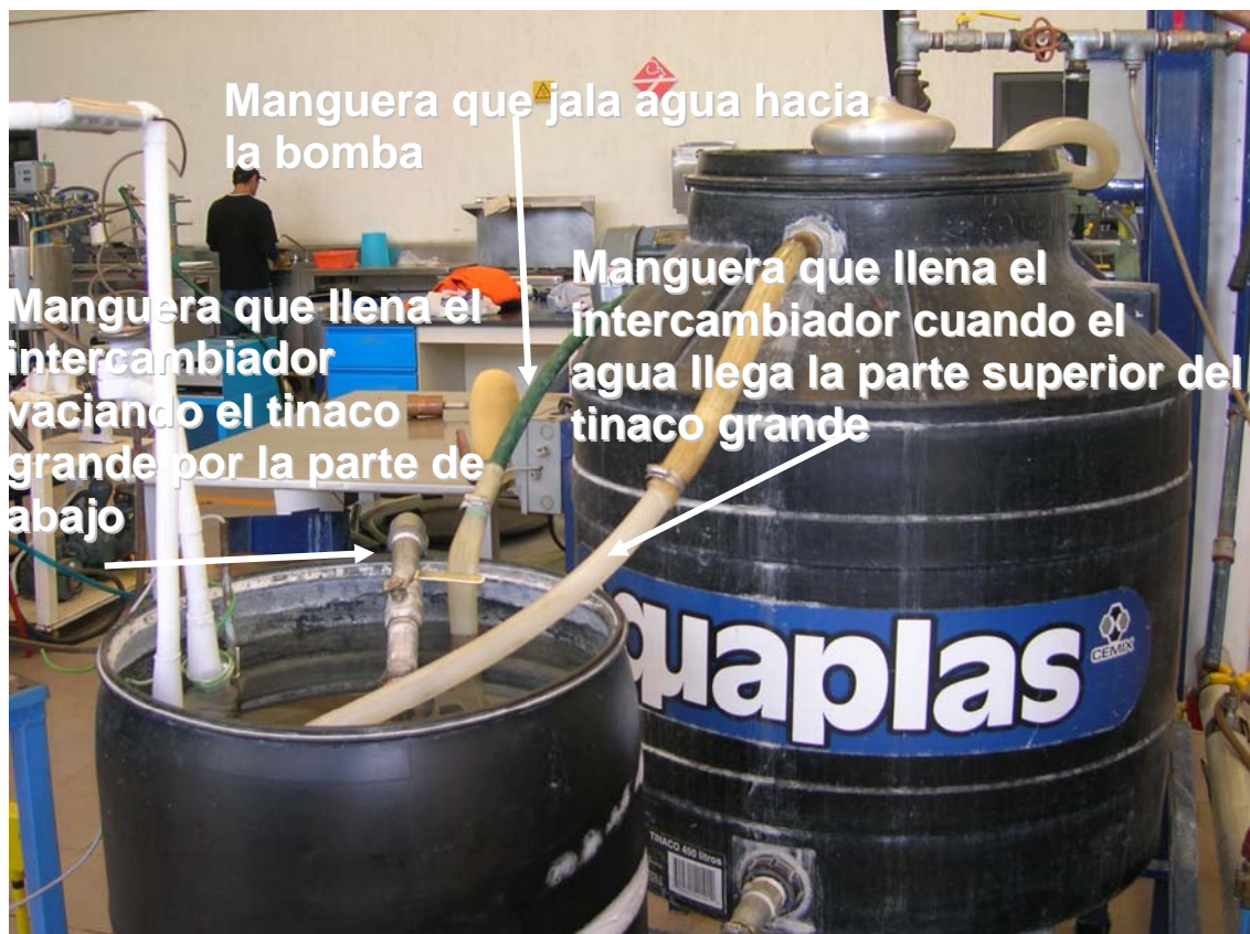
Figura H.8. Sistema de mangueras para aumentar eficiencia de intercambiador.
