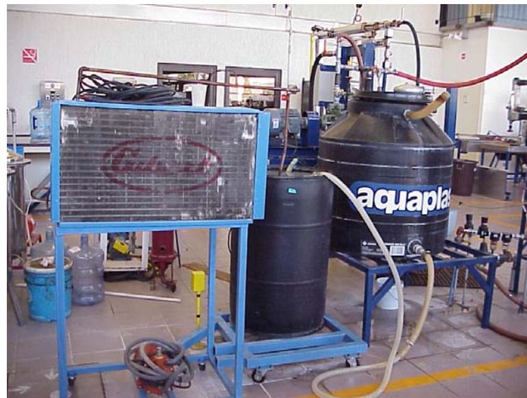
FIGURA 5.1 Sistema de enfriamiento del agua
