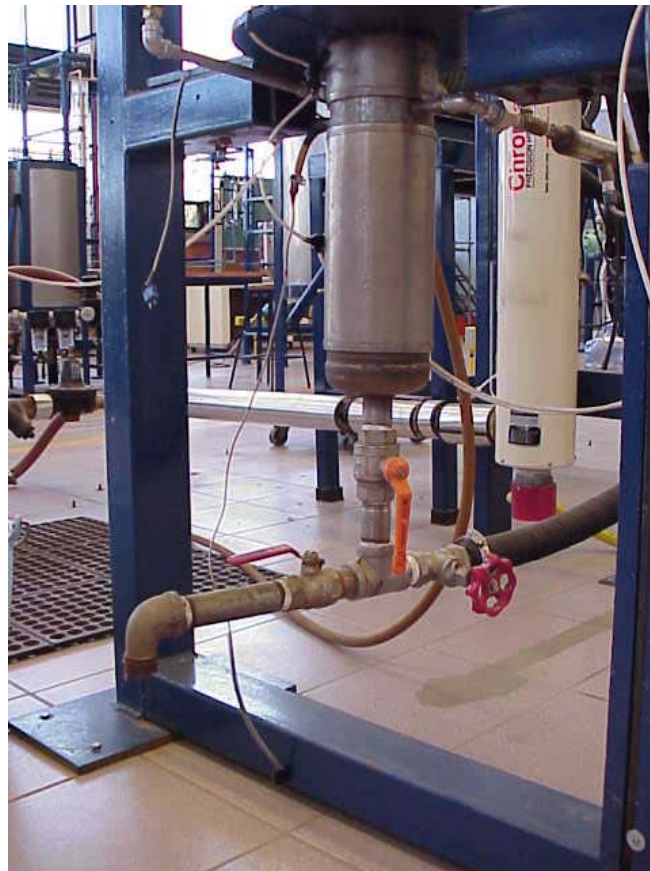
Figura 4.6 Última purga del equipo antes de que el vapor entre en la columna.
