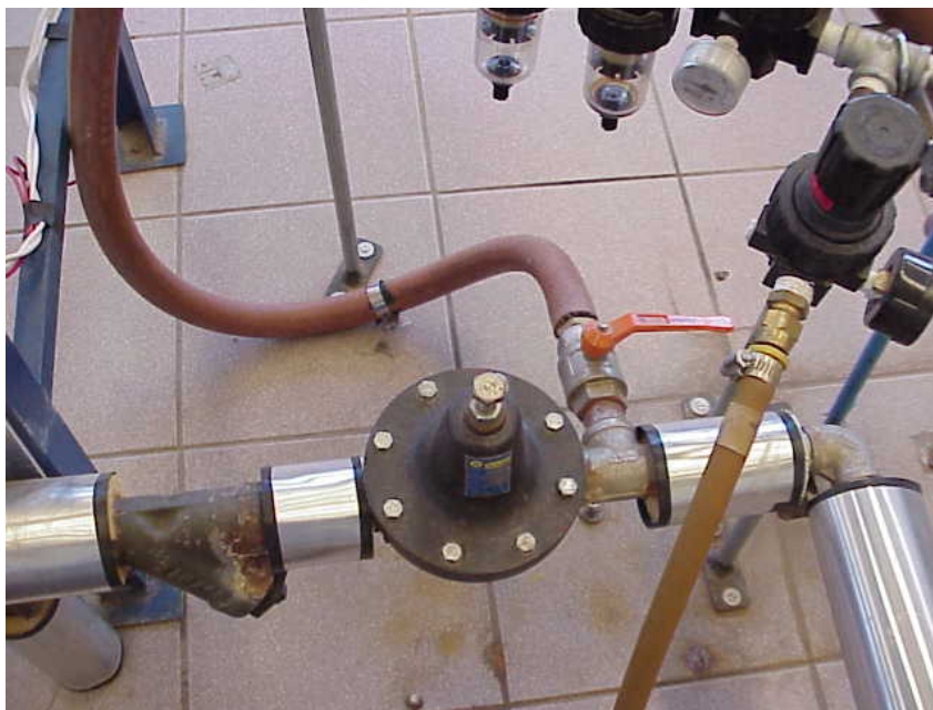
Figura 4.3 Primera purga del sistema. Se puede observar la válvula de bola que regula la salida de vapor a través de la primera purga instalada por Guarneros [13].
