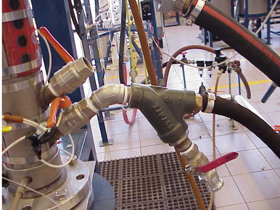
Figura 4.11 Dispositivo para toma de muestras atornillado en la toma inferior
