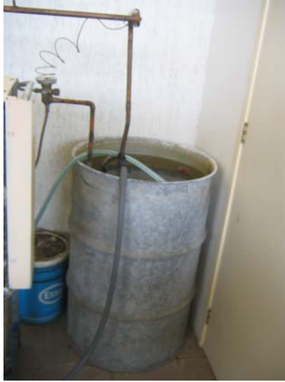
Figura 4.20. Tanque estacionario en el cual se descargará el agua caliente y se tomará agua fría para el buen funcionamiento de la bomba de vacío.
