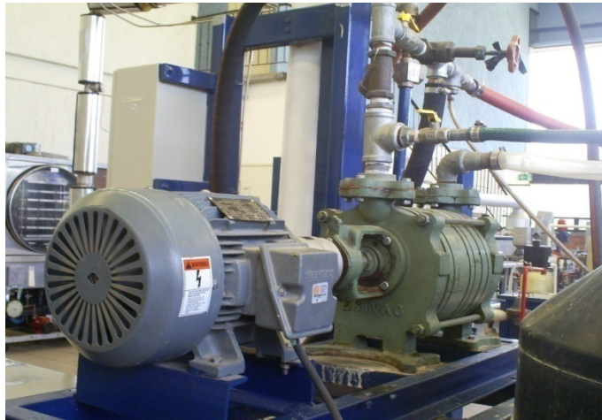
Figura 5.6 A la izquierda motor trifásico y a la derecha bomba.
