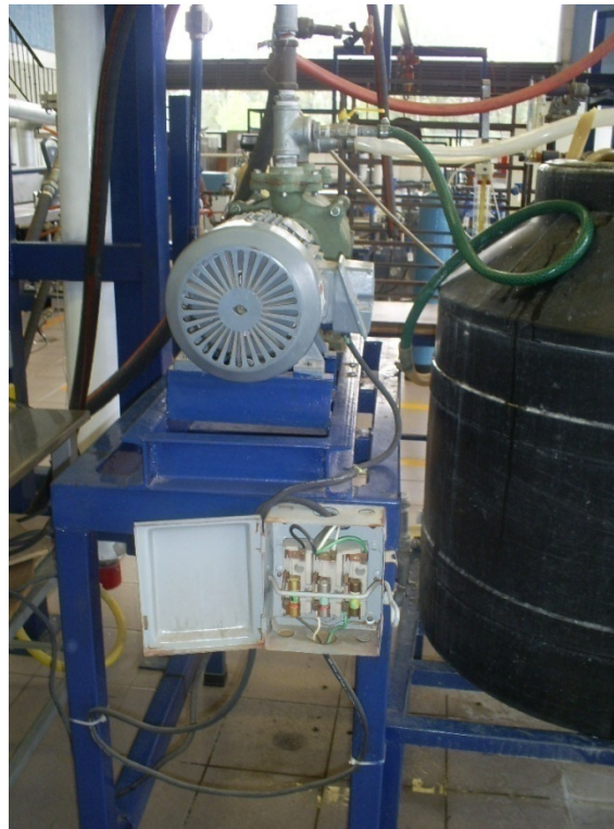
Figura 5.8 Motor, fusibles y tinaco.
