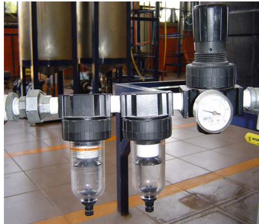
Figura 5.14 Sistema de filtración de aire.
