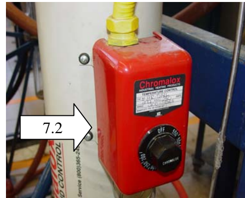
Figura 7.8.2 Control de temperatura.
