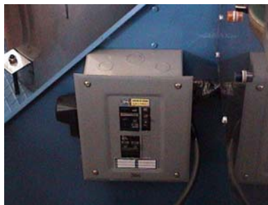
Fig. 6.18 Centro de Carga.
