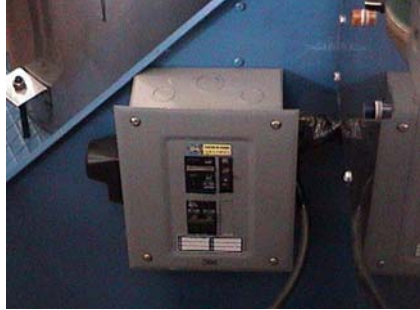
Fig. 4.5 Centro de Carga.
