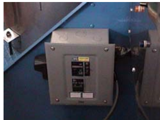
Centro de Carga.
