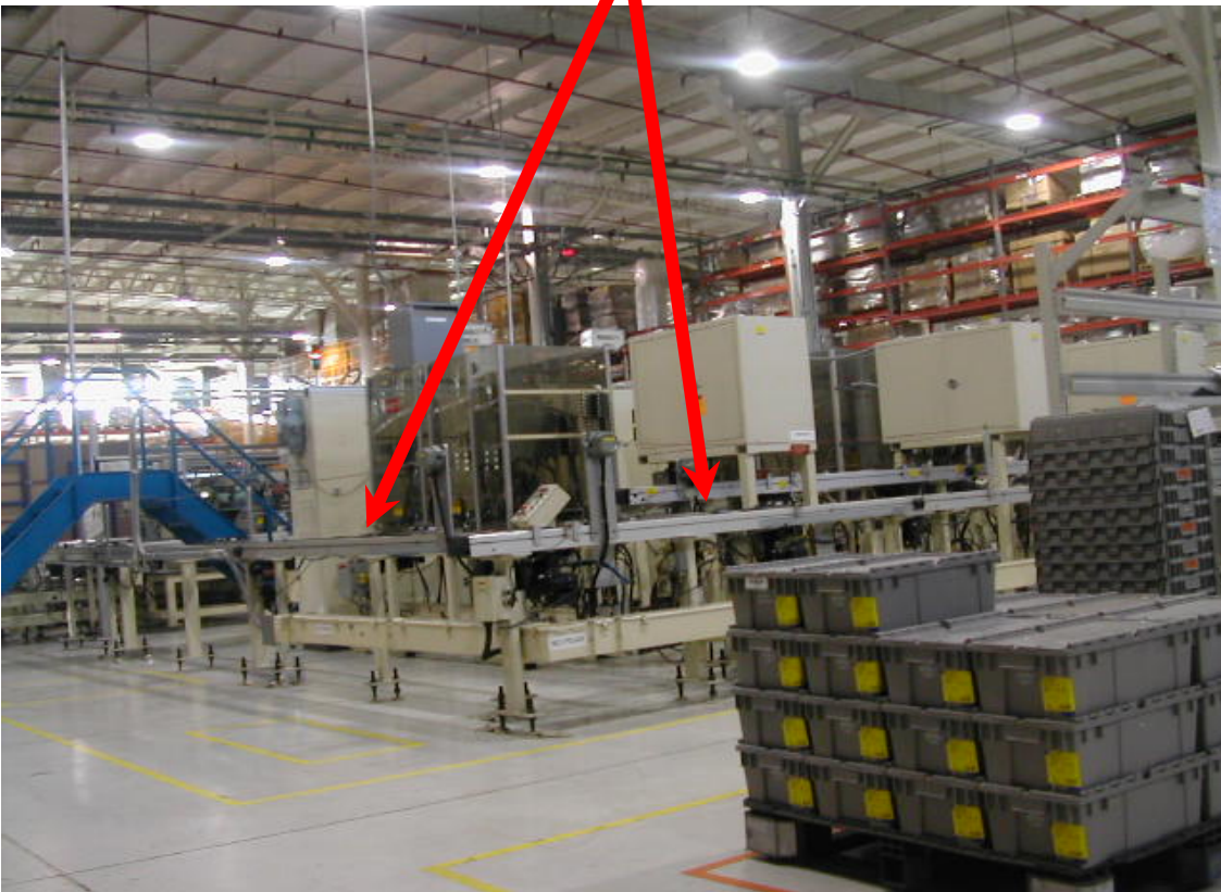
Figura 1.7 Automatización Schneider Electric – Tlaxcala. (Vista Lateral)
