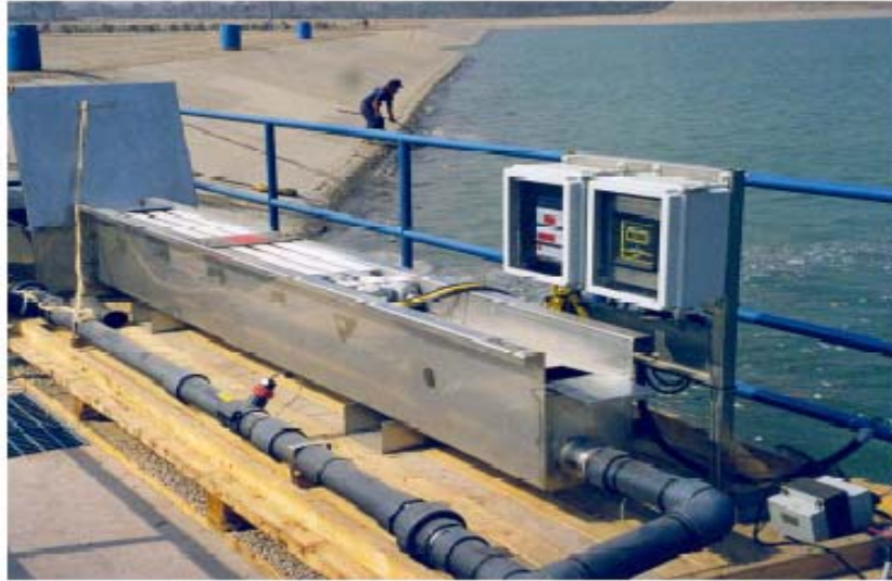
Figura 2.5 Sistema de tubos paralelos al flujo instalado en una planta potabilizadora.
