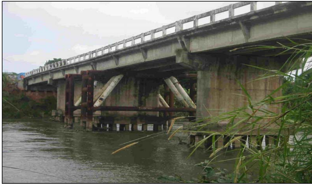
Figura 1.8 Asentamiento en el Apoyo No.3
