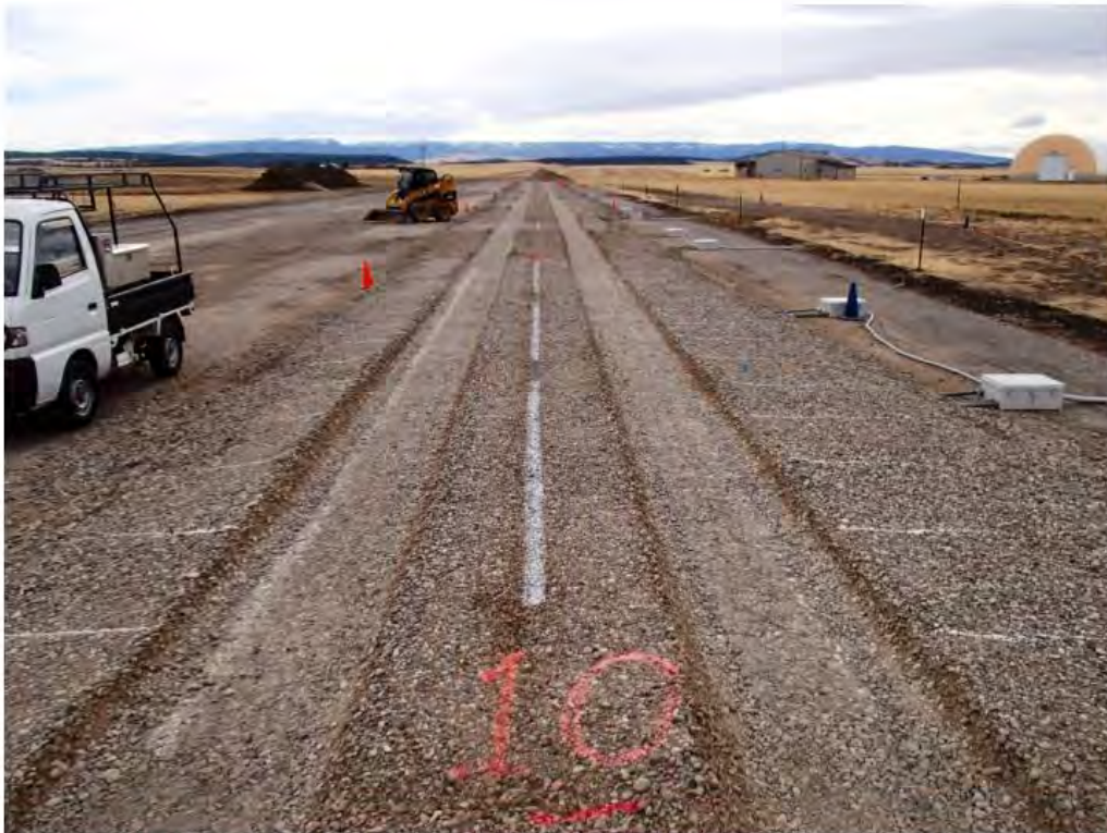
Figura 53.- Fotografía en la sección 10 con aproximadamente tres pulgadas de deformación permanente o rodadura (Cuelho E., Perkins S. & Morris Z., 2014).
