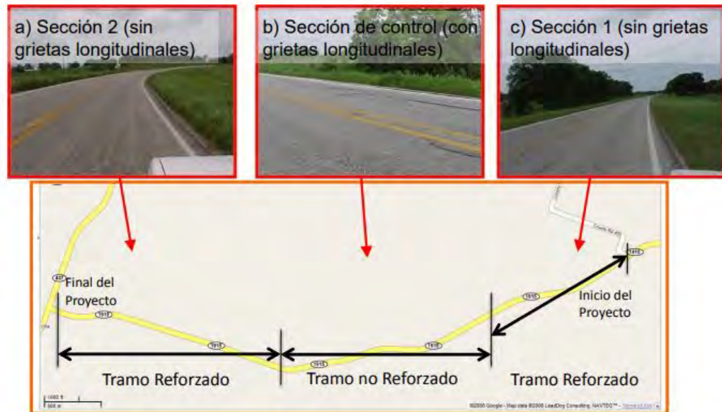
Figura 29.- Comparación del desempeño de secciones de pavimento sobre arcillas expansivas: (a) Sección 2 reforzada con geomalla; (b) Sección de control (no reforzada); (c) Sección 1 reforzada con geomalla (Zornberg J.G., 2012).
