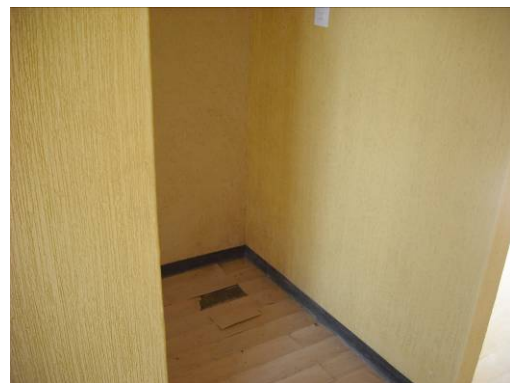
Figura 5.1.4 Vista del piso humedecido y losetas desprendidas.
