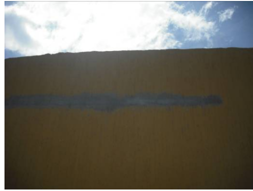
Figura 5.3.2. Grieta sellada con mezcla.
