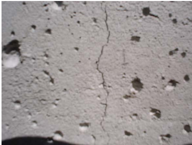
Fig. 4.4 Agrietamiento en el Espécimen con Hule de Llanta.
