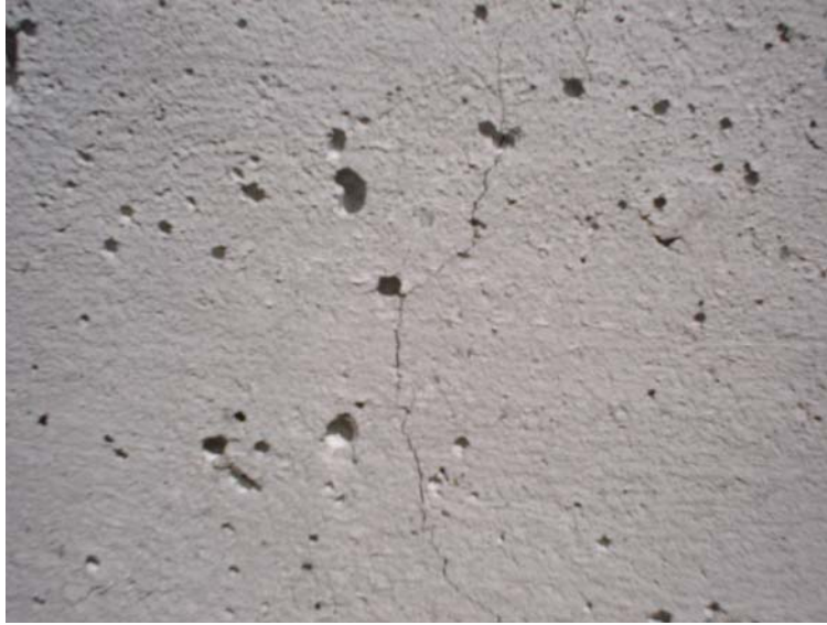
Fig. 4.3 Agrietamiento en el Espécimen con Malla Electrosoldada.
