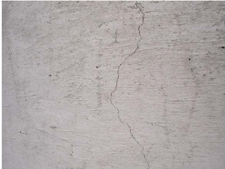
Fig. 4.2 Aparición de la Primera Grieta.
