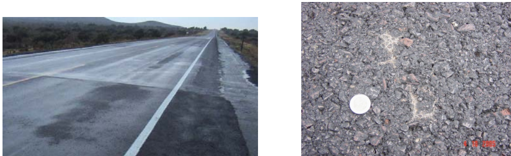
Figura 4.2 Comportamiento del tramo con problemas de adherencia
