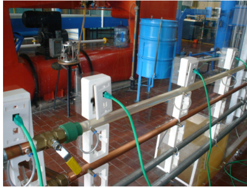
Fig. 4.13 Captura de la presión de una tubería.
