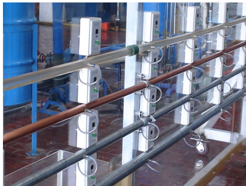
Fig. 4.12 Sensores instalados en la planta hidráulica.
