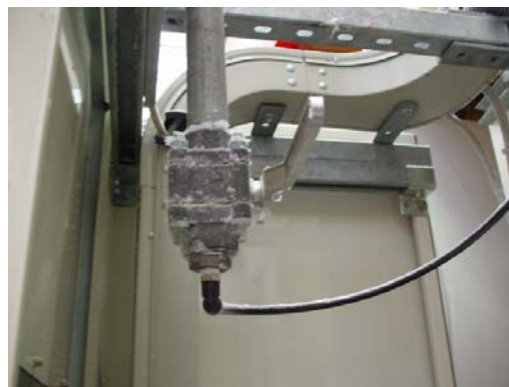
Figura 21. Válvula cerrada que no permite que le llegue la señal neumática al pistón que mueve la mampara de la campana automáticamente.
