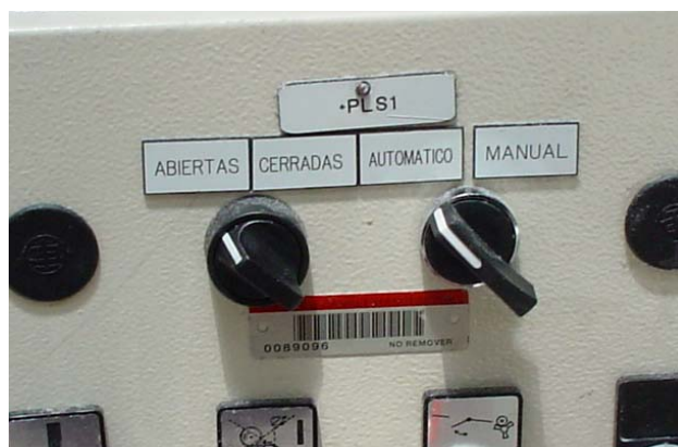
Figura 19. Tablero de control que permite poner el sistema en manual o automático.
