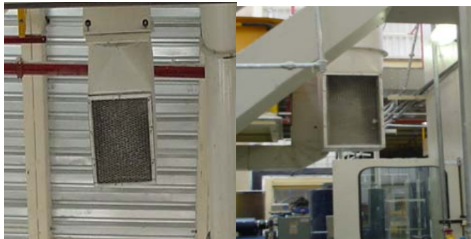
Figura 16. Rejillas de succión ubicadas fuera de la cabina.
