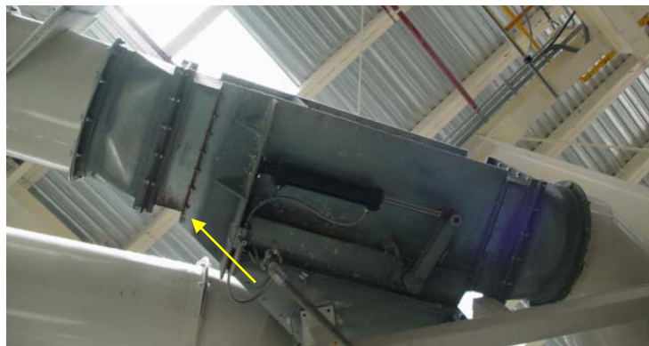
Figura 18. Compuerta que abre para accionar las campanas de extracción dentro de la cabina. La flecha señala el pistón que mueve la compuerta.
