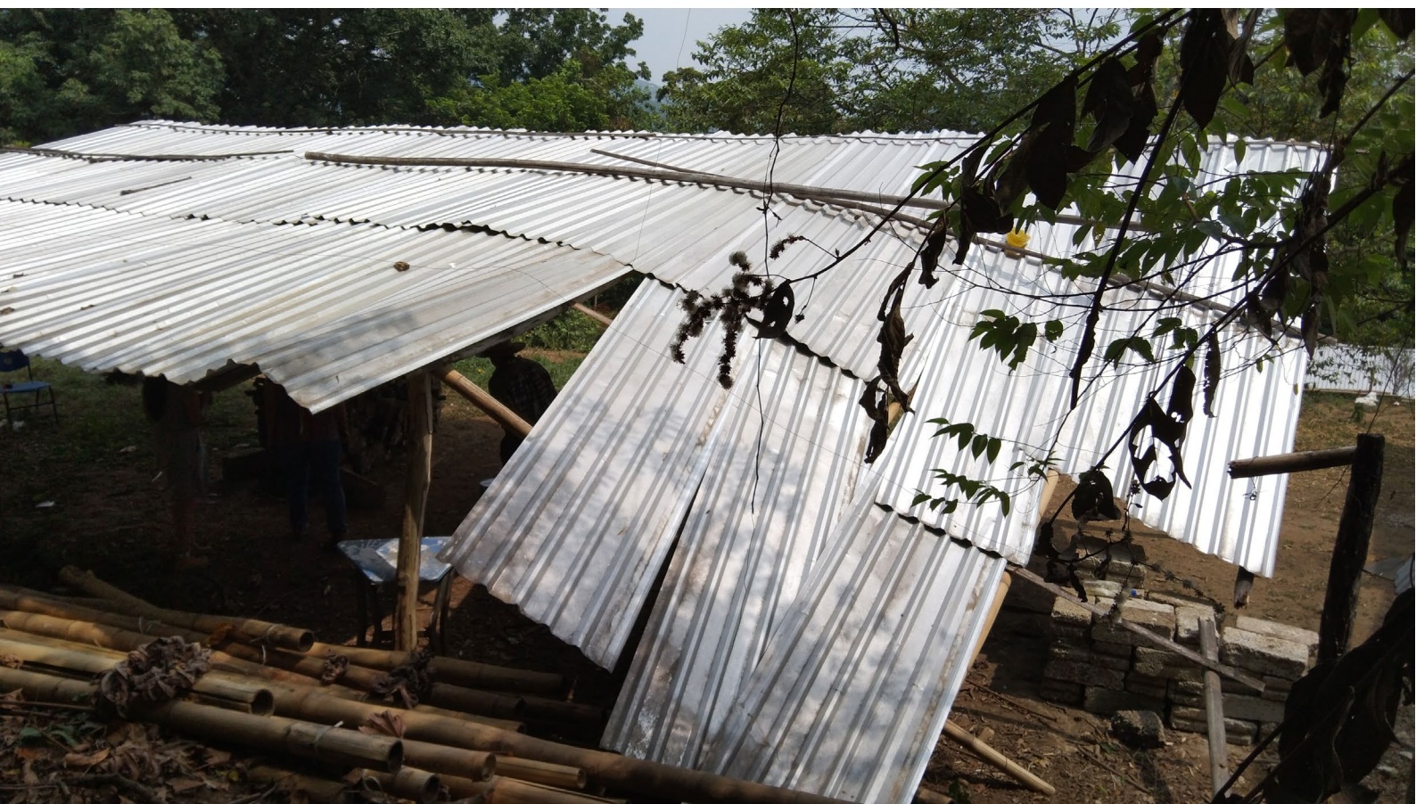
Estructura que se destruyó | Foto: Equipo Landlab | 2023
