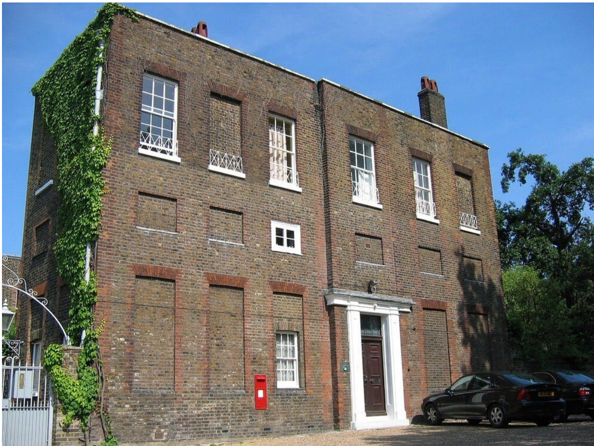
Vivienda con ventanas tapeadas Países Bajos | Andy Billman | 2021
