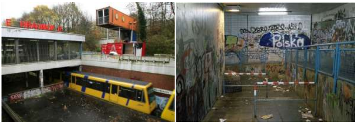
Imagen C10 : Falta de mantenimiento en los espacios de la estación. (fuente: www.flickr.com )
