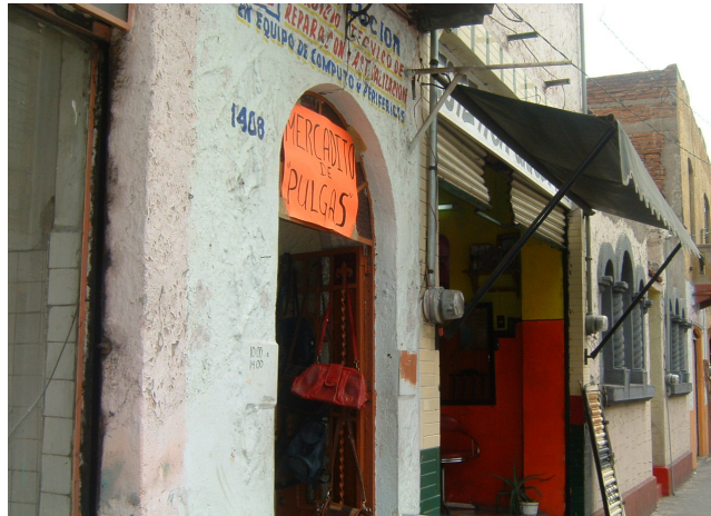
FOTO 4: Las actividades comerciales que se dan en el centro degradan tanto la imagen urbana como la condición de los inmuebles del Centro Histórico (Foto del autor).
