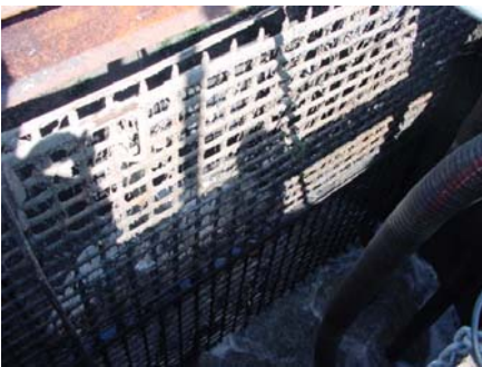
Reja para basura, planta de tratamiento de aguas "Las Rosas"
