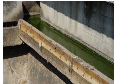
Canal de entrada de flujo al tanque.
