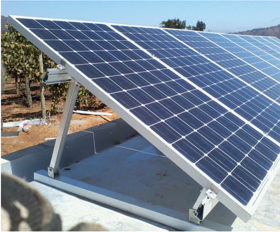
Uso de paneles fotovoltaicos monocristalinos para la generación de energía eléctrica. ▲
