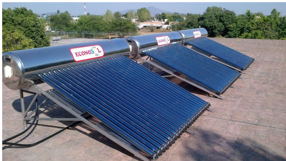
Calentadores solares instalados en la azotea de un edificio. ▼
