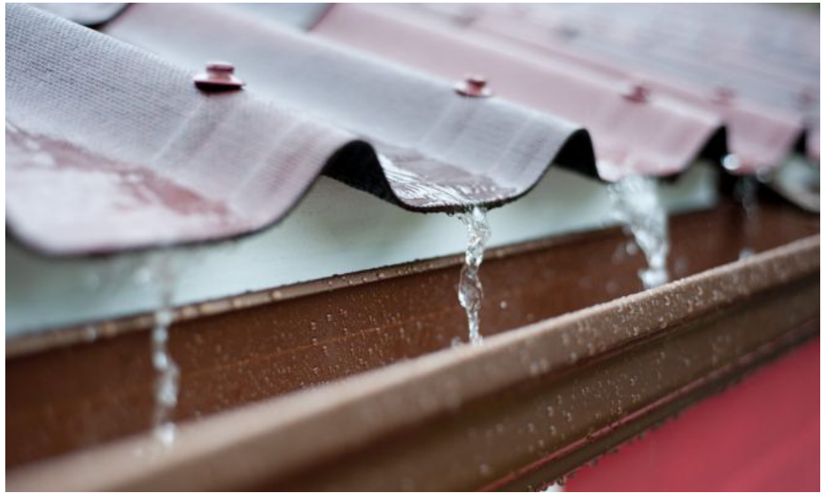
Captación del agua pluvial mediante el uso de canaletas, que direccionan el agua hacia los depósitos. ▲
