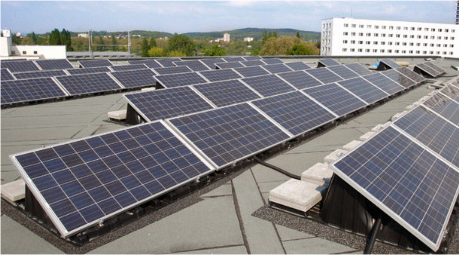
Paneles fotovoltaicos policristalinos para la generación de energía eléctrica. ▲
