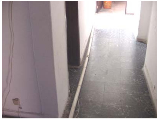
Tuberías al exterior
